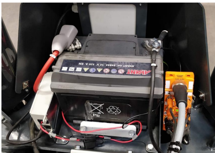
Figur 22 Batteriet er plassert på bakenden av chassiset
